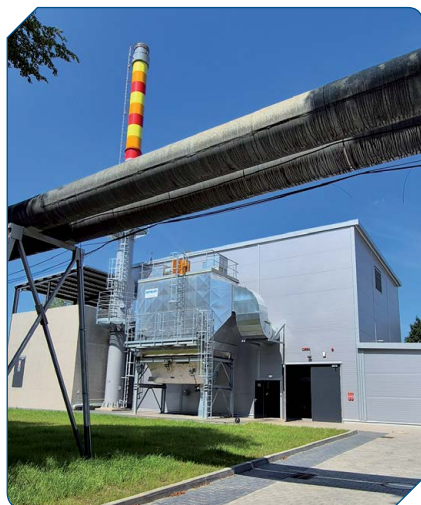
Kotłownia na zrębkę drzewną o mocy 6 MW BINDER, inwestycja w woj. opolskim
